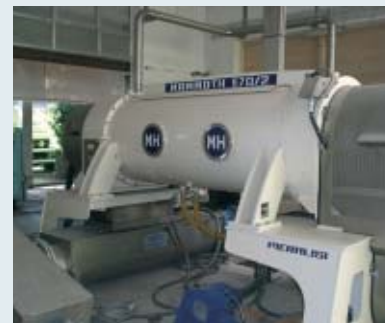
Trattamento fango anaerobico - Anaerobic sludge treatment - Traitement des boues anaérobiques
