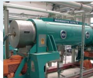
Trattamento fango aerobico - Aerobic sludge treatment - Traitement des boues aérobiques
