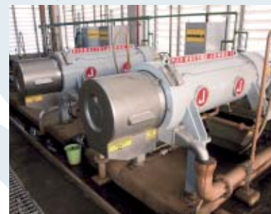
Trattamento fanghi biologici - Biological sludge treatment - Traitement boues biologiques
