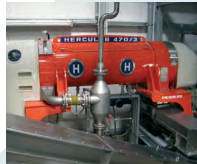
Trattamento fanghi da biomasse Biomass sludge treatment Traitement des boues de biomasses
