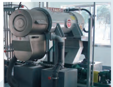
Trattamento prodotti chimici - Chemical products treatment - Traitement de produits chimiques
